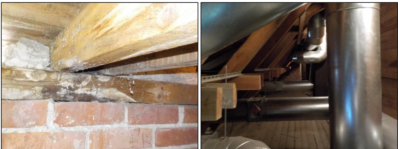
Kuva 4.16. Vasemmalla rakenneavauksen AYP-1 läheisyydessä havaittu mikrobikasvustoa. Oikealla yleiskuvaa yläpohjasta ja vesikatosta rakennetyypin YP1 alueelta.
