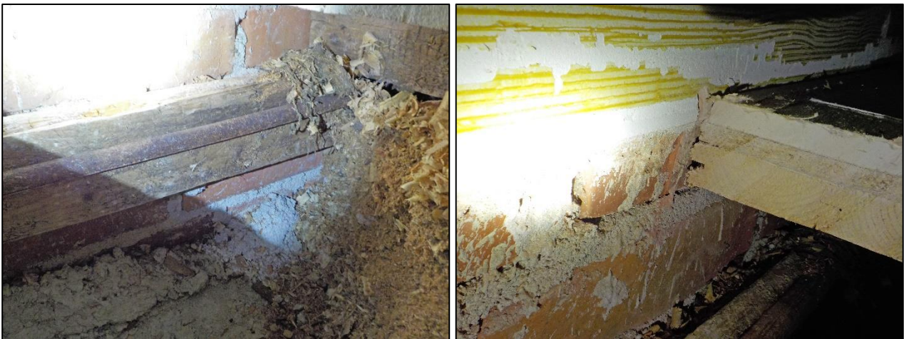
Kuva 4.12. Rakenneavauksesta AVP-1 silmämääräisesti tehtävien havaintojen perusteella vaurioituminen on pahempaa lähempänä ulkoseinän muurausta kuin etäämmällä tästä. Oikeanpuolimmaisesta kuvasta nähdään hyvin, että asennusvarojen takia rakenteeseen muodostuvaa ilmarakoa ei ole tiivistetty. Kuvasta poistettu muovinen jalkalista ei ole ollut tiiviisti asennettuna. Ilmavuotoreitti on siten sijainnut suoraan pahimmaksi katsottujen ongelmien kohdalla.
