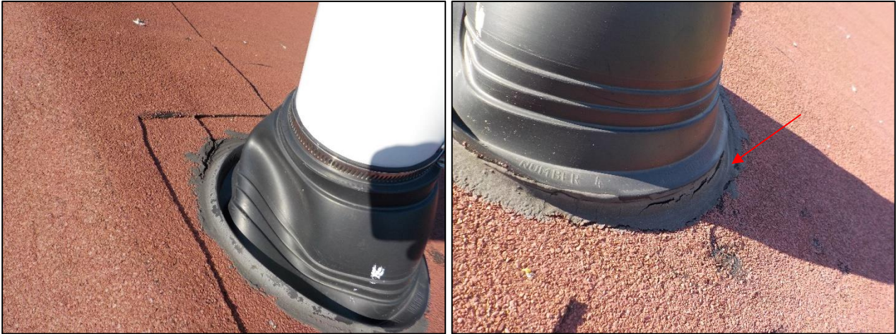
Kuva 4.20. Putkiläpivientejä on toteutettu eri kattokaltevuuteen tarkoitetun läpivientikappalein ja asennus on jouduttu suorittamaan pakottamalla. Tämä lisää vuotoriskiä ja lyhentää läpivientien elinkaarta.
