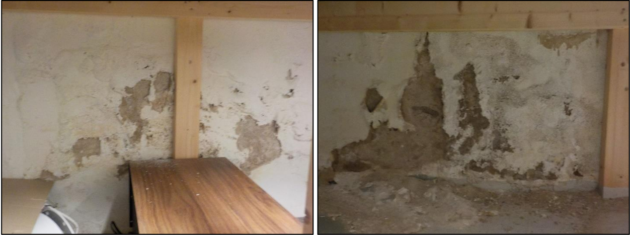
Kuva 4.5. Yleiskuvia seinän maalipinnan kosteusvaurioista rakenneavauksen AMVS-3 läheisyydestä.
