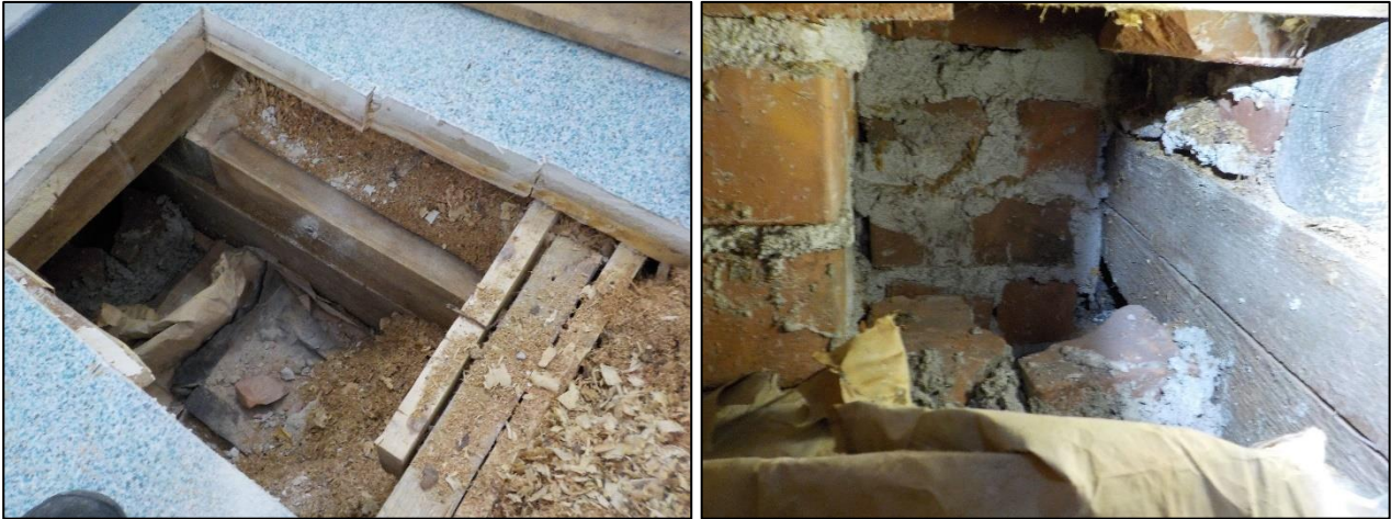
Kuva 4.13. Valokuvia rakenneavauksesta AVP-2: vasemmalla yleiskuva avauksesta. Oikealla nähdään esi- merkki siitä, kuinka välipohjan puurakenteita on aikakauden rakennustapaan liittyen upotettu ulkoseinän tiilimuurauksen sisään. Tällaisen palkin pää on yleensä suurimmassa vaurioris- kissä.
