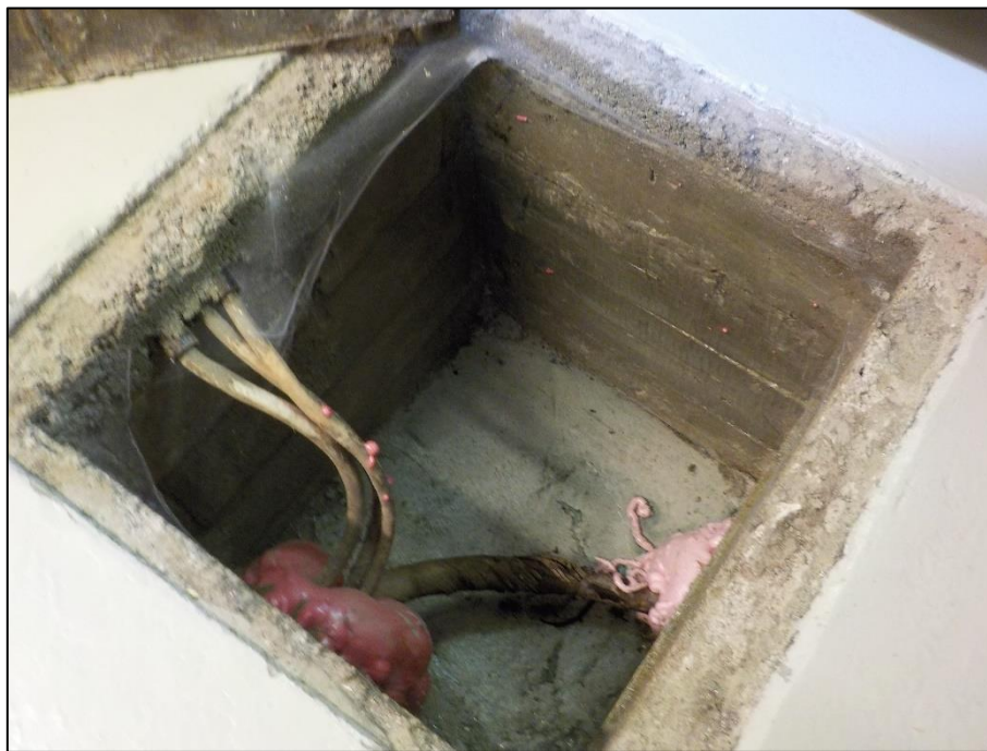
Kuva 4.3. Yleiskuva kellarin lattiassa olevasta tekniikkaluukusta, joka on siistitty ja läpivientejä on tiivistetty polyuretaanivaahdolla.
