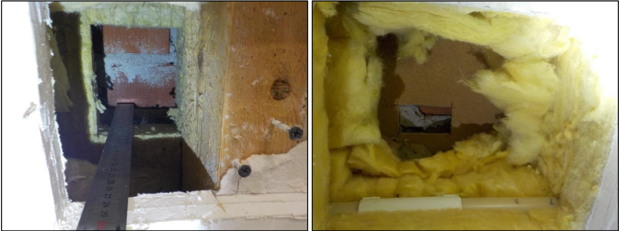
Kuva 4.15. Yleiskuvat rakenneavauksista AUS-10 ja AUS-11. Vasemmalla olevassa rakenneavauksessa AUS-10 tuuletusvälin syvyys on 100 mm, kun taas oikealla olevassa rakenneavauksessa AUS-11 tämä on vain noin 15 mm ja tiilimuurauksen laastipurseet kaventavat tuuletusvälin kokoa vielä tätäkin enemmän.
