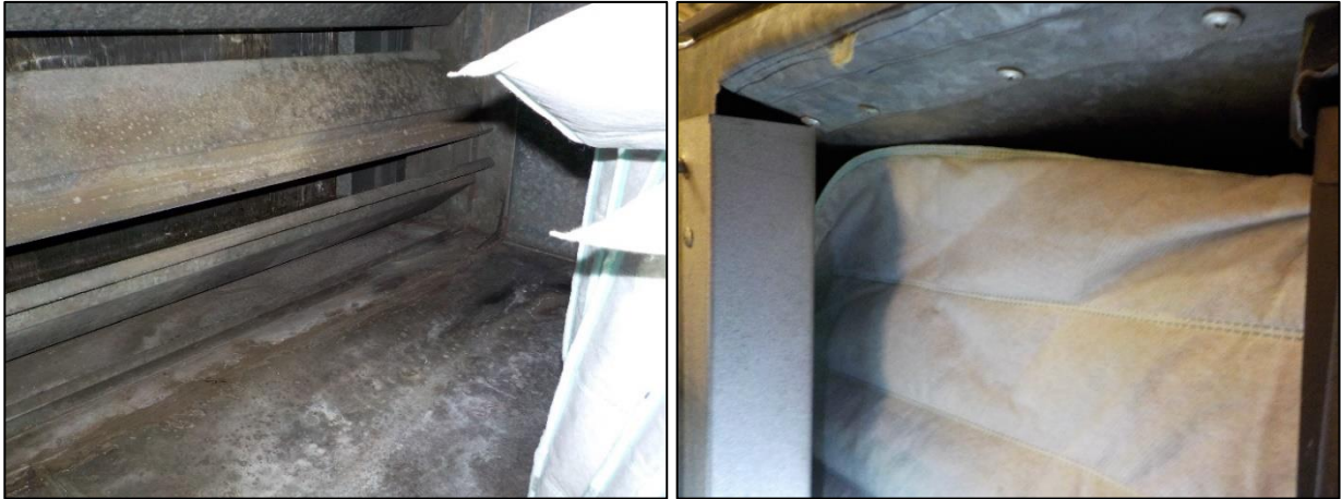
Kuva 5.1. Vasemmalla yleiskuva tuloilmakammioista ja oikealla tuloilmasuodattimen vähäinen taite, joka pienentää suodattimen toimivaa suodatuspinta-alaa.
