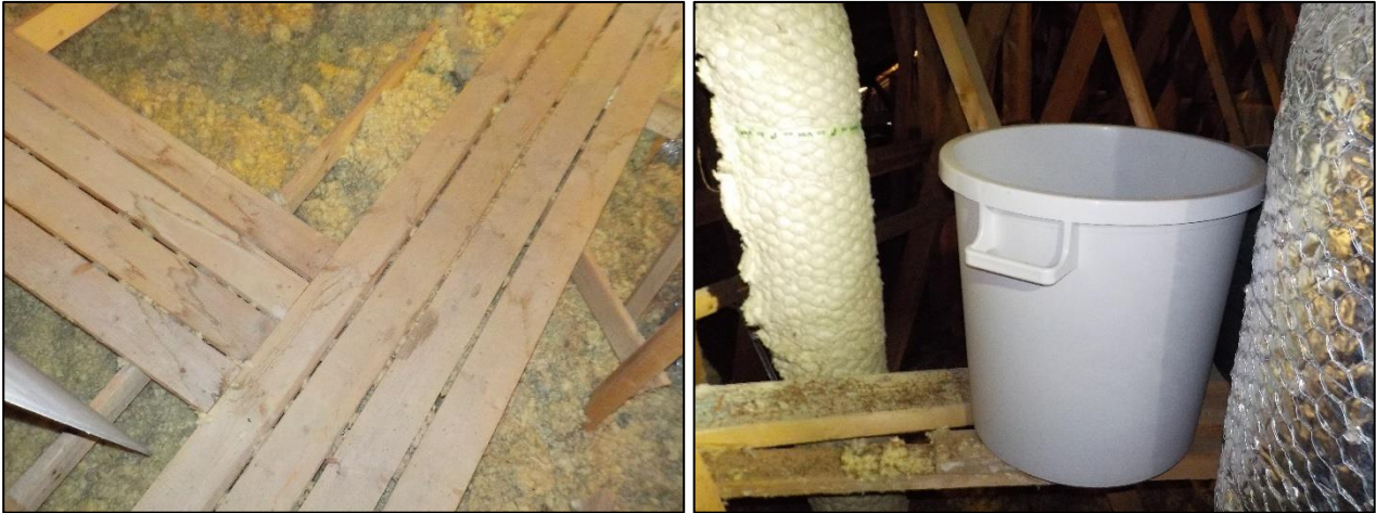
Kuva 4.22. Yläpohjan kulkusilloissa on nähtävissä kosteusjälkiä viitteenä kattovuodoista. Vuotovesiä yritetään mitä ilmeisimmin kerätä myös ämpärein.
