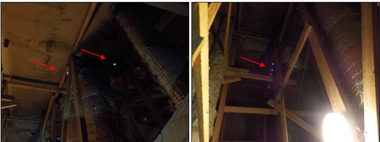
Kuva 4.23. Vesikatto ei muodosta tiivistä kokonaisuutta, sillä läpivientien yhteydestä voidaan nähdä monia mahdollisia vuotoreittejä.
