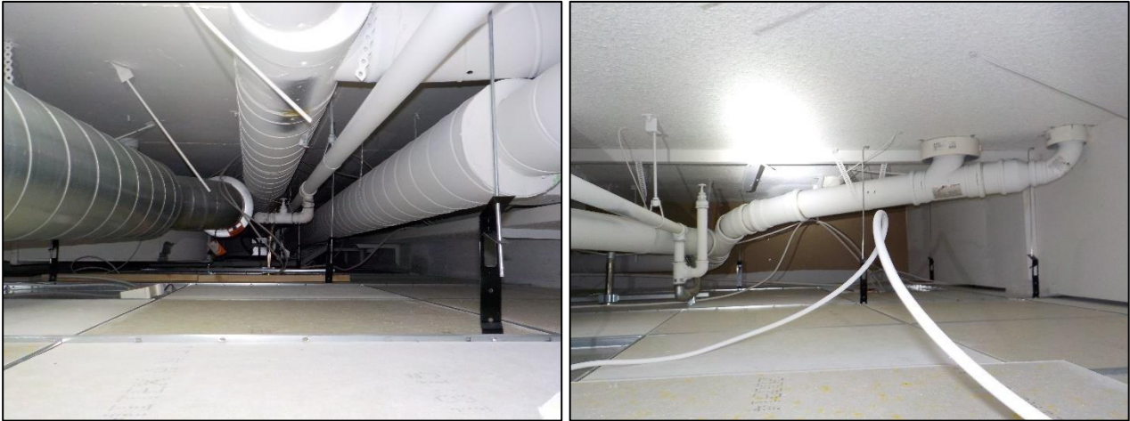
Kuva 4.19. Yleiskuvia alaslaskujen sisältä: vasemmalla avaus AVP-1 ja oikealla avaus AVP-3. Molemmat avaukset ovat poliklinikan tiloissa ja alaslaskujen uusinta on sisällytetty suoritettuihin sisätilojen pintaremontteihin.
