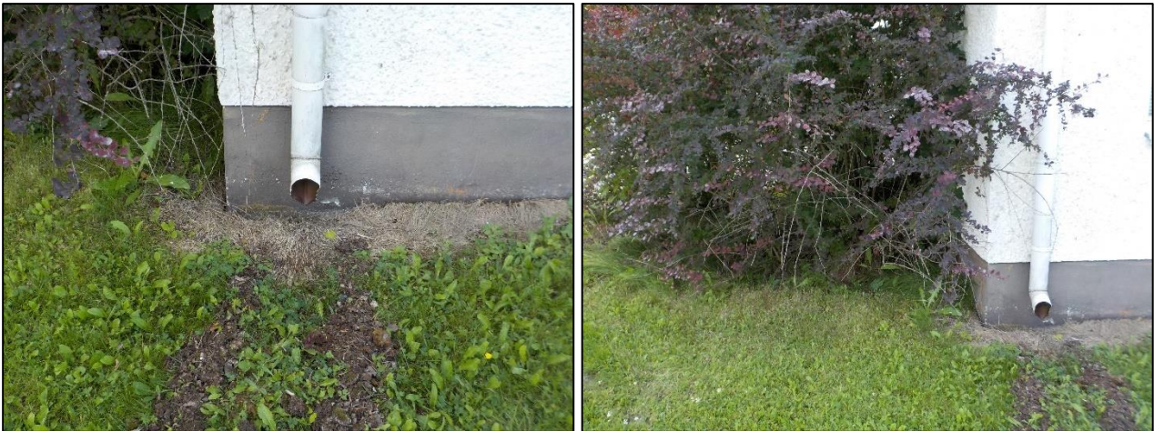
Kuva 4.1. Yleiskuvia kuivatusrakenteiden toteutuksesta: syöksyn alla ei ole rännikaivoa ja sokkelissa on paikallisesti kiinni kasvillisuutta.
