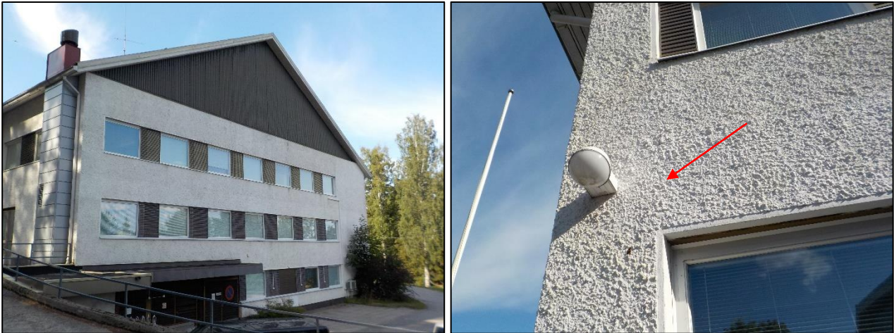
Kuva 4.10. Yleiskuvia julkisivuista: julkisivuissa ja näiden rappauspinnassa on yksittäisiä vaurioita, kuten ikkunapielistä ja nurkista alkavaa halkeilua.
