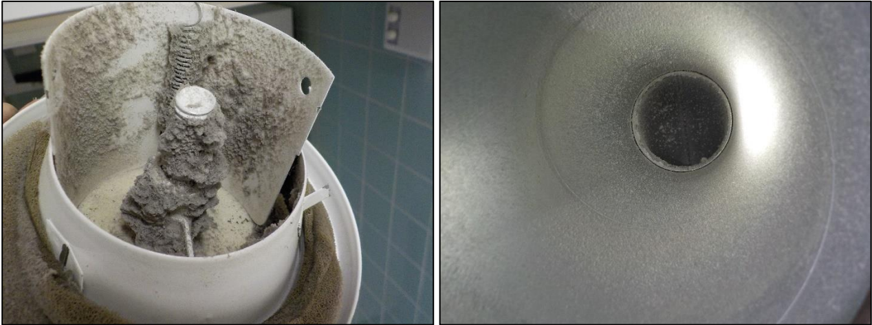
Kuva 5.5. Poistoilmaventtiileissä ja poistoilmakanavissa paikoin huomattavaa pölykertymää.
