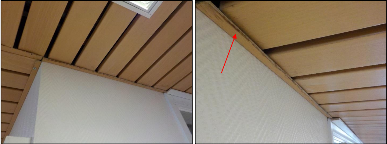
Kuva 4.24. Sisäkaton ja väliseinän valumajälkiä 2. kerroksen oleskeluhuoneen kulmassa.
