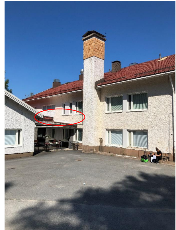
Kuva 30. Laajennusosan kattorakenne lisää seinärakenteeseen kohdistuvaa kosteusrasitusta (näyte 27).
