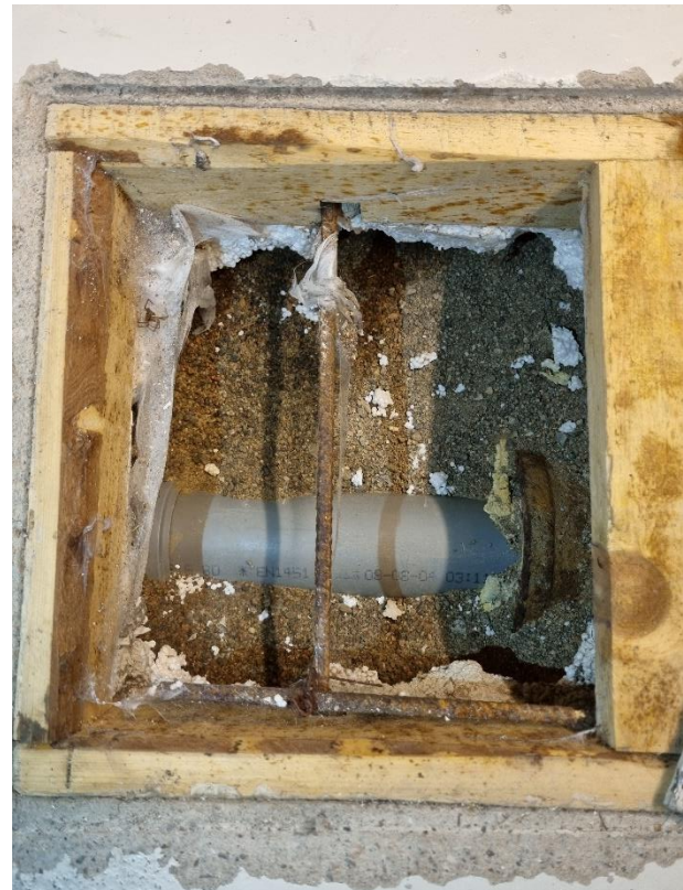
Kuva 9. Viemärin tarkastusluukuissa puurakenteita.
