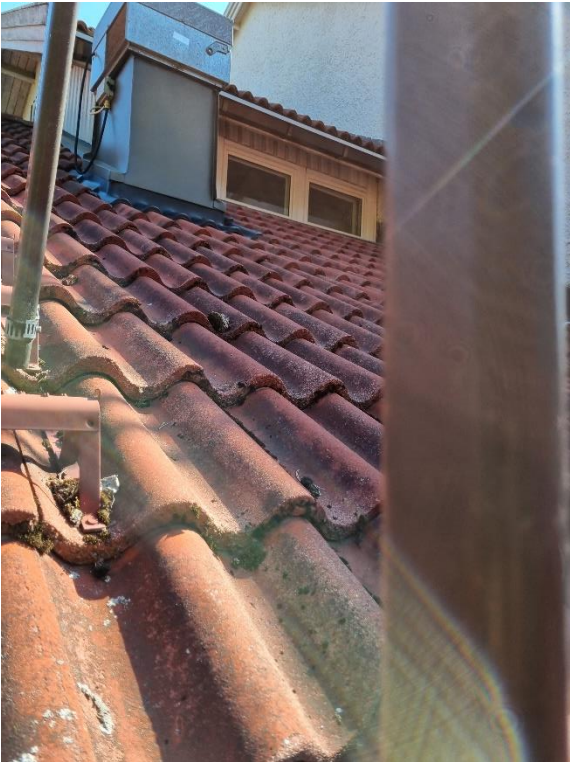
Kuva 39. Tiilikate osin sammaloitunut.
