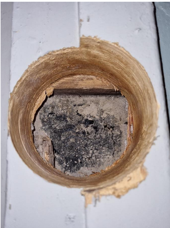
Kuva 11. Puurakenteet alkavat lattiapintaa alemmaa. Kynnyksen alapuolisissa kiiloissa aistinvaraisesti havaittavissa tummentumaa, mikä viittaa kosteusrasitukseen.
