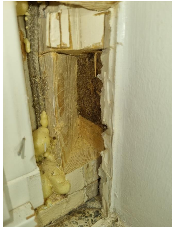
Kuva 34. Vanhojen karmien ja seinärakenteen välissä pellavarivettä tilkkeenä.
