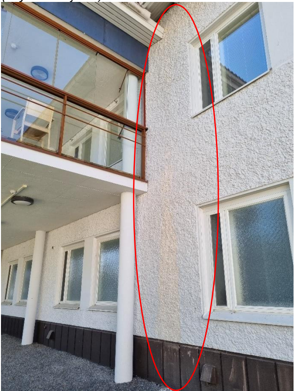
Kuva 29. Parvekkeen vieressä, ylhäältä alas, havaittavissa kattosadevesien aiheuttamaa värimuutosta rappauspinnassa (näytteet 28 ja 19).
