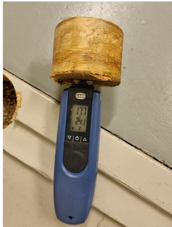
Kuva 12. Puun piikkikosteusmittarilla tarkasteltuna kynnyksen alapinnoissa havaittiin kohonnutta kosteutta.
