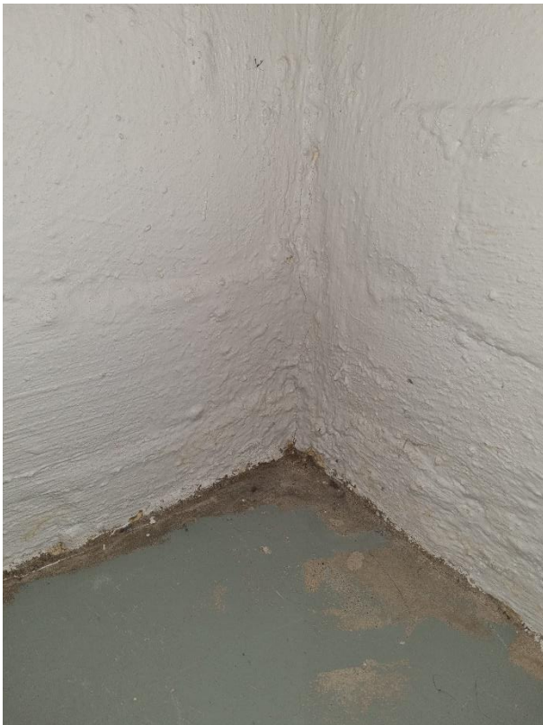
Kuva 8. Lattian maalipinnoite osin irronnut, todennäköisesti alapuolisen kosteusrasituksen seurauksena.
