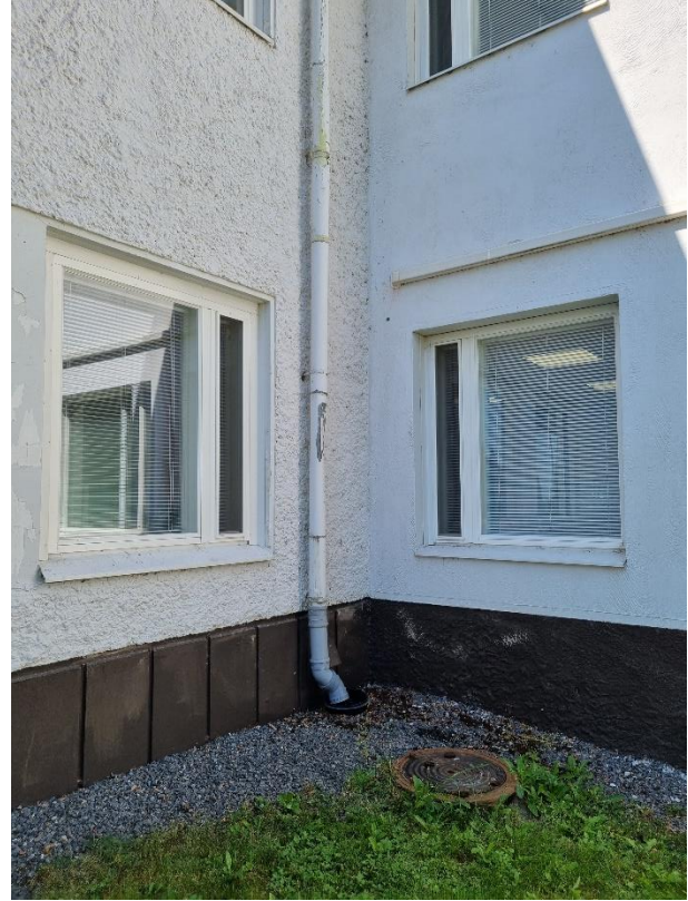
Kuva 28. Sadevesien syöksytorvet osin huonokuntoisia (näyte 21).
